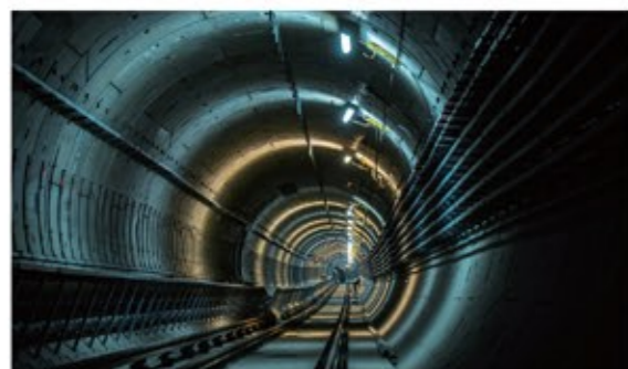
项目名称: 杭州地铁9号线一期 服务类型: 第三方安全巡检 项目概况: 总长度约为17公里, 总投资额为178亿元
